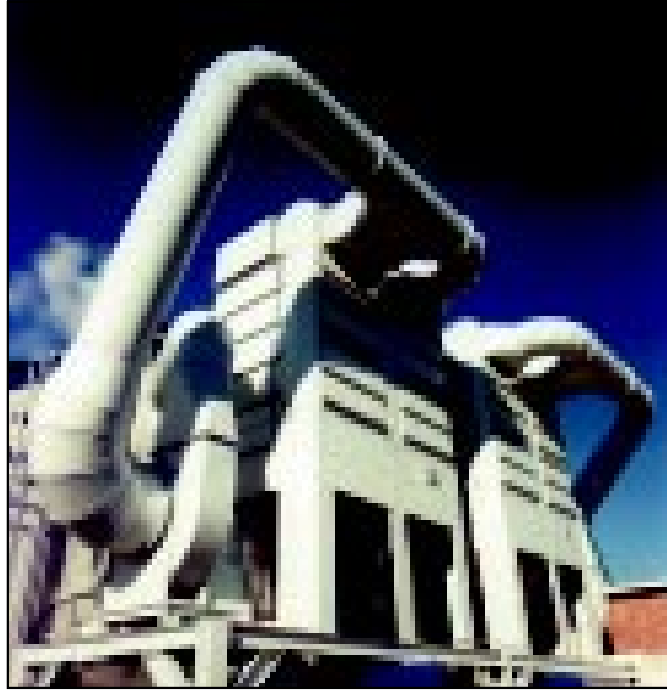
2 корпусных блока Юниселл 320Р для удаления пыли при пескоструйной обработке резины.
